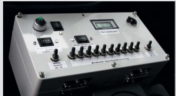
Bedienpult im Fahrerhaus zur Steuerung der Anspritzfunktionen.
